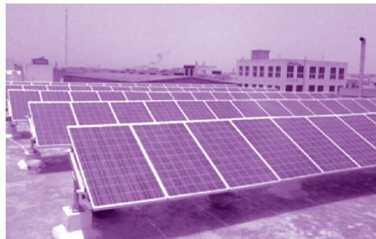
▲ 屋頂型太陽能光電系統
